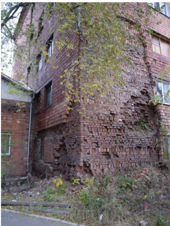
Фасад аварийного общежития, г. Черногорск, октябрь 2023 года
