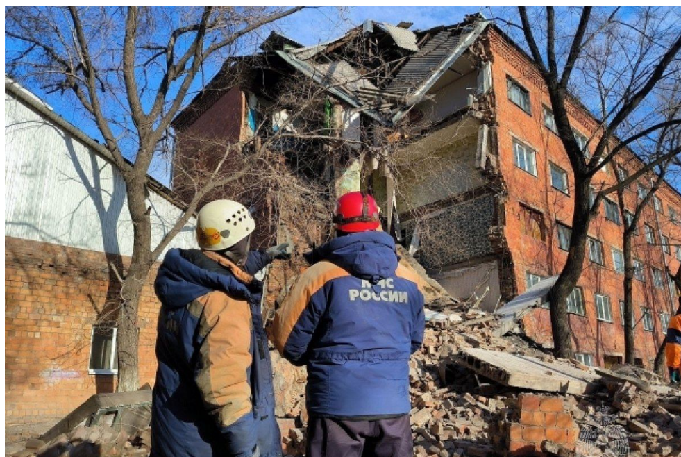
Фасад аварийного общежития после обрушения угла здания 14 марта 2024 года
